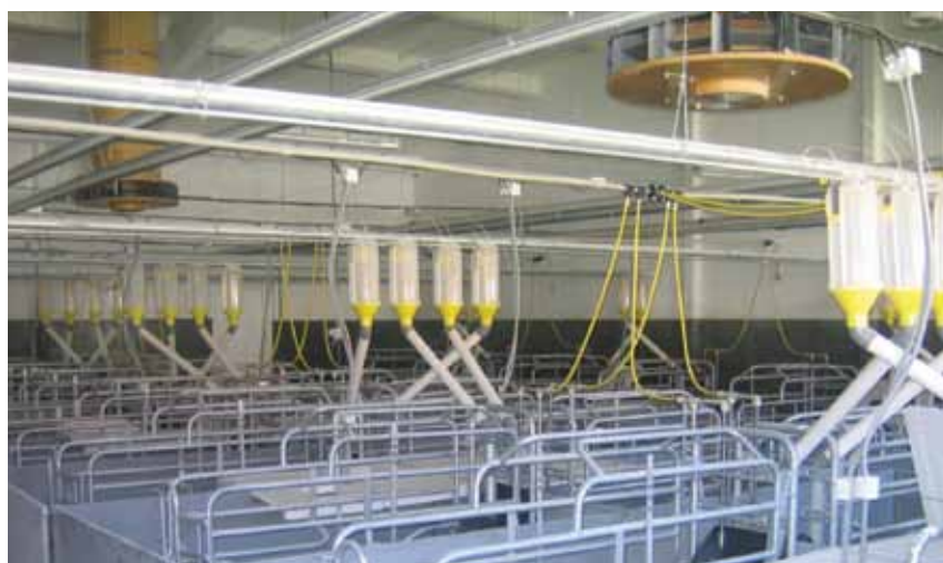
Рис. 3. Помещение для подсосных свиноматок. Система вентиляции с применением приточных крышных шахт.
