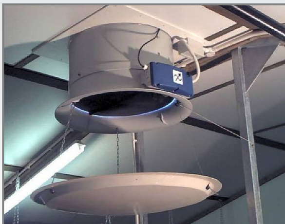
Вытяжная шахта DA 600
